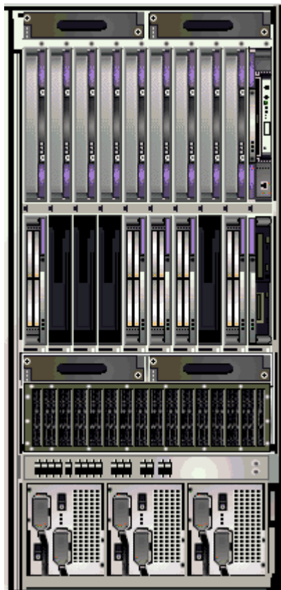
图 5-2 Sun Fire 高端系统平台物理视图—正面
