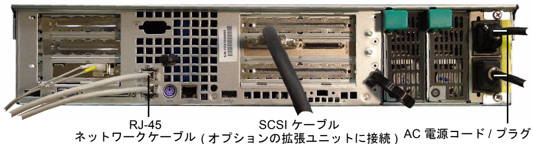
図 2-15 Sun StorEdge 5210 NAS の AC 電源ケーブルの接続
